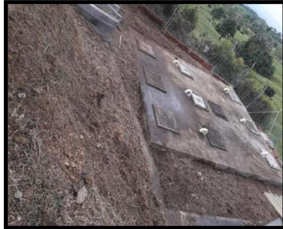
PTAR CORREGIMIENTO LA IBERIA
